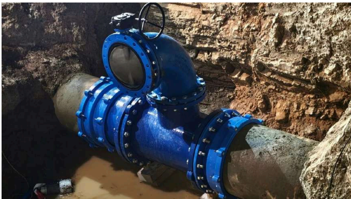
Válvula instalada por Emalgesa en la Cota 100.
